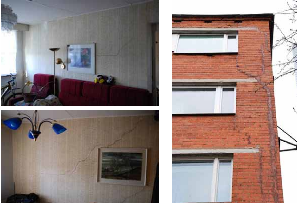
Joonis 2.18 Praod hoone pöikikandeseintes (vasakul) ja otsaseinas (paremal), mis on tekkinud vundamendi vajumisest ja müüritise ebakvaliteetsusest.
