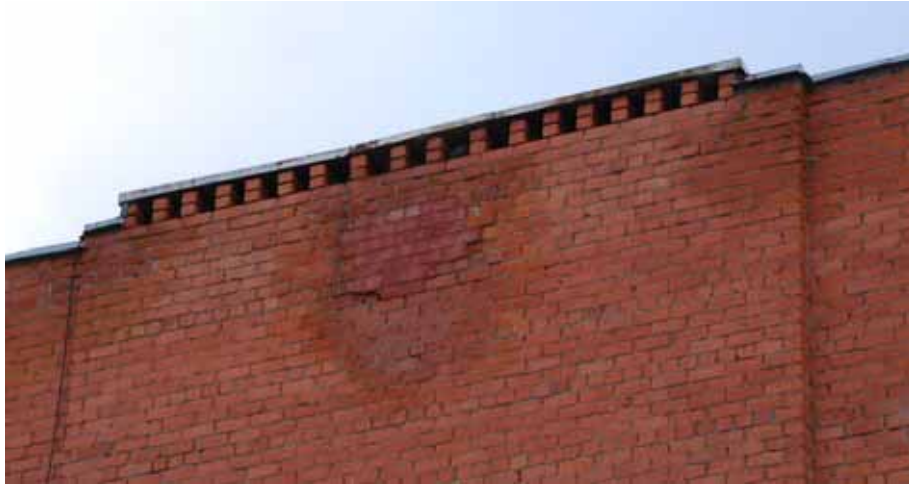
Joonis 2.14 Fassaaditelliste lagunemist võib põhjustada ka ventilatsioonikorstna ülemises osas kondenseeruv veeaur ja korstna puudulikud katteplekid.
