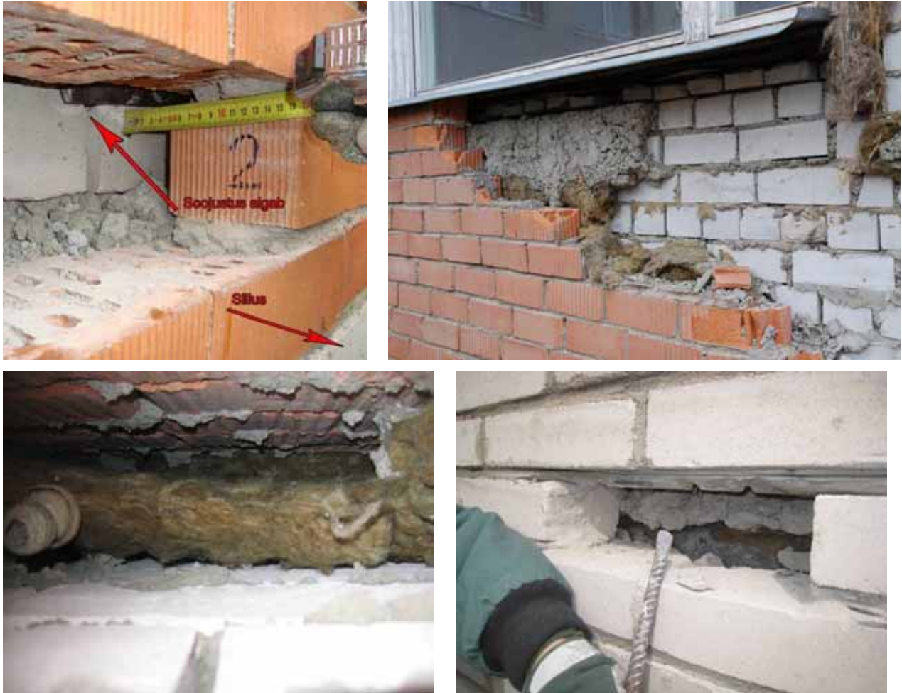
Joonis 2.20 Telliselamu välisseina puudulik soojustus.
