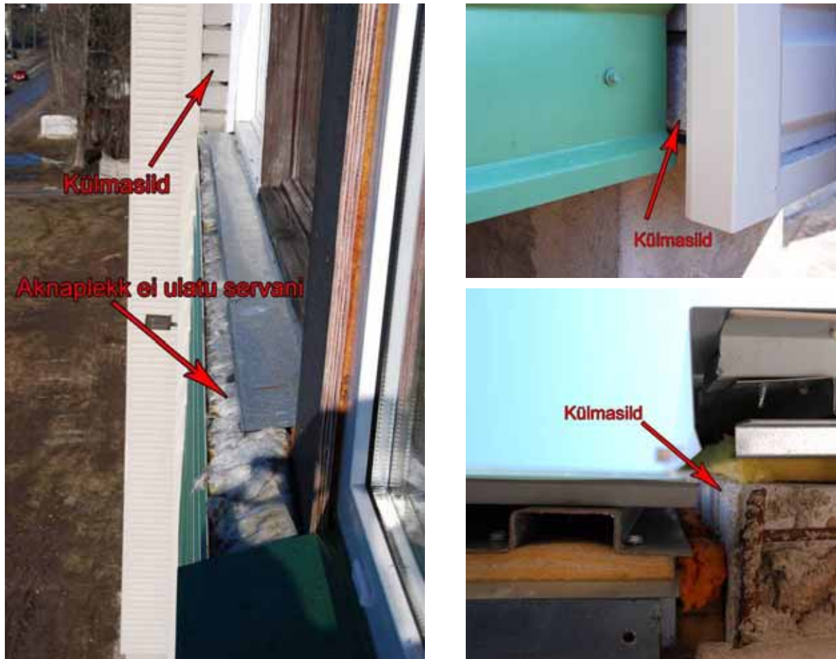
Joonis 2.21 Ehituslahendusi lähemalt vaadates ilmneb tõsist ehituspraaki: paigaldamata aknaplekkide tõttu on soojustus kaitsmata (vasakul), puuduliku seina liitekohta lahenduse tõttu on tekitatud külmasild (paremal).
