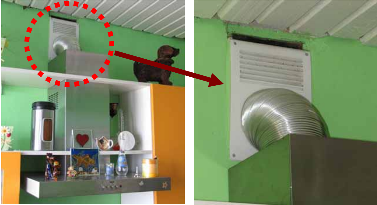
Joonis 13.4 Köögi kubuga on suletud köögi ventilatsioonikanali rest.
