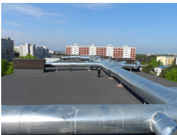
Joonis 3.14. Ventilatsioonitorustik katusel.
