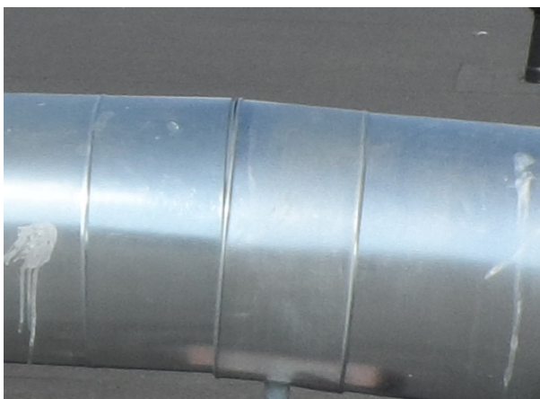
Joonis 3.15. Defektne katteplekk.
