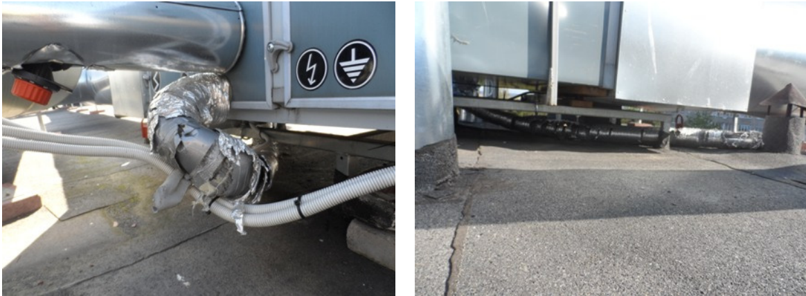
Joonis 3.16. Defektne kondensaadi äravoolutoru isolatsioon (vasakul) ja keskelt nõgus kondensaaditoru (paremal).
